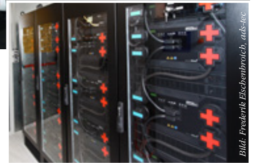
In den Batterien wird der Solarstrom gespeichert und nach Bedarf in das Betriebsnetz des HIU eingespeist.
